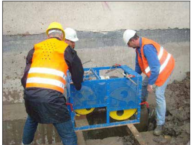
Hình 5: Máy siêu âm được lắp đặt tại panel
