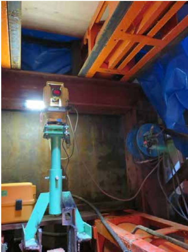
Hình 7 – Máy trắc đạc được đặt cố định, theo dõi liên tục trong quá trình thi công
